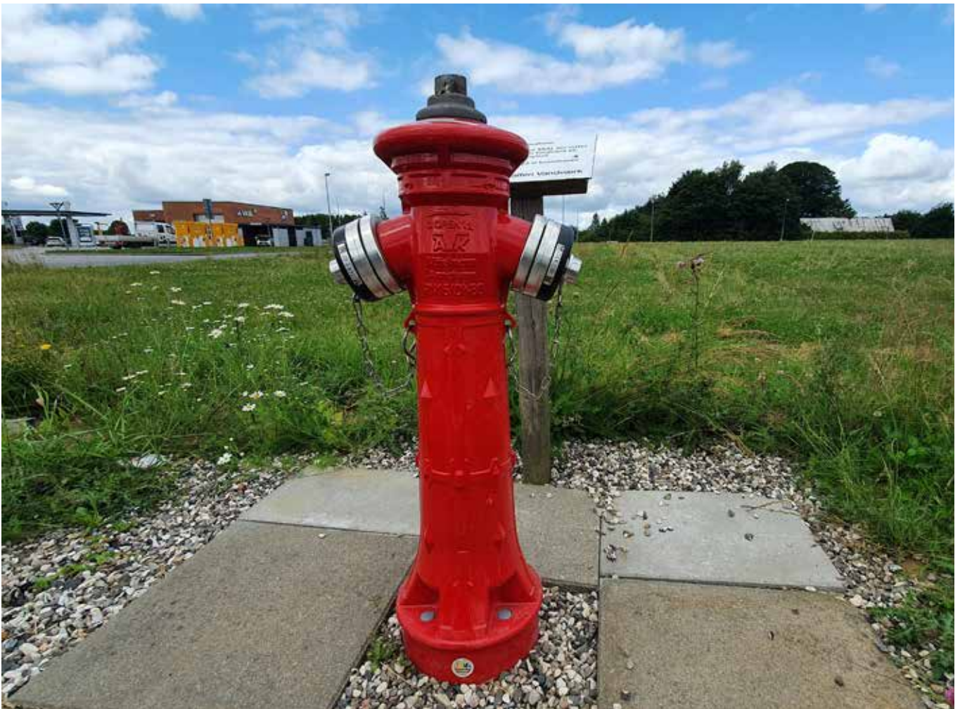
Brandhane med VIDI Cap installeret. Når en brandhane bruges, påvirker det trykket i området. Derfor er det vigtigt for forsyningselskabet at vide, hvornår brandhanen er i brug for at skelne mellem trykfald fra almindelig brug og fra rørbrud.
