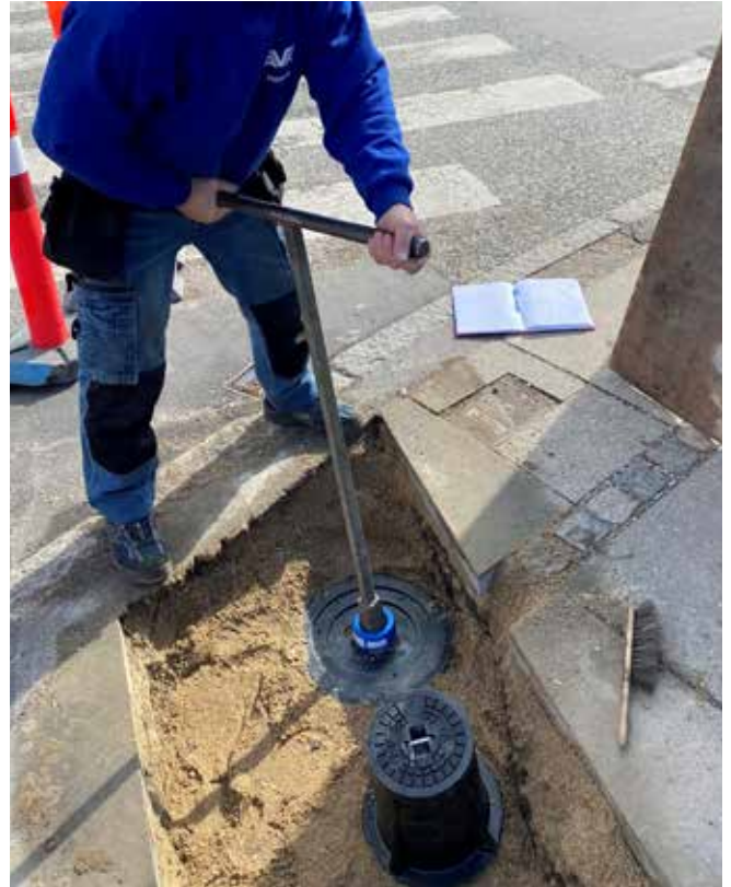
Skydeventil installeret under jord med VIDI Positioner, der registrerer, hvornår ventilen betjenes.
